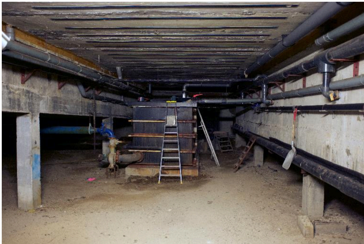
Sous-sol, galerie technique, dessous des cuves des bassins.
