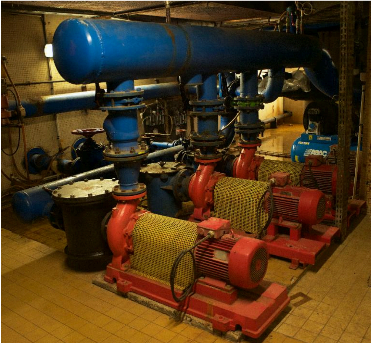
Pompes de filtration.
