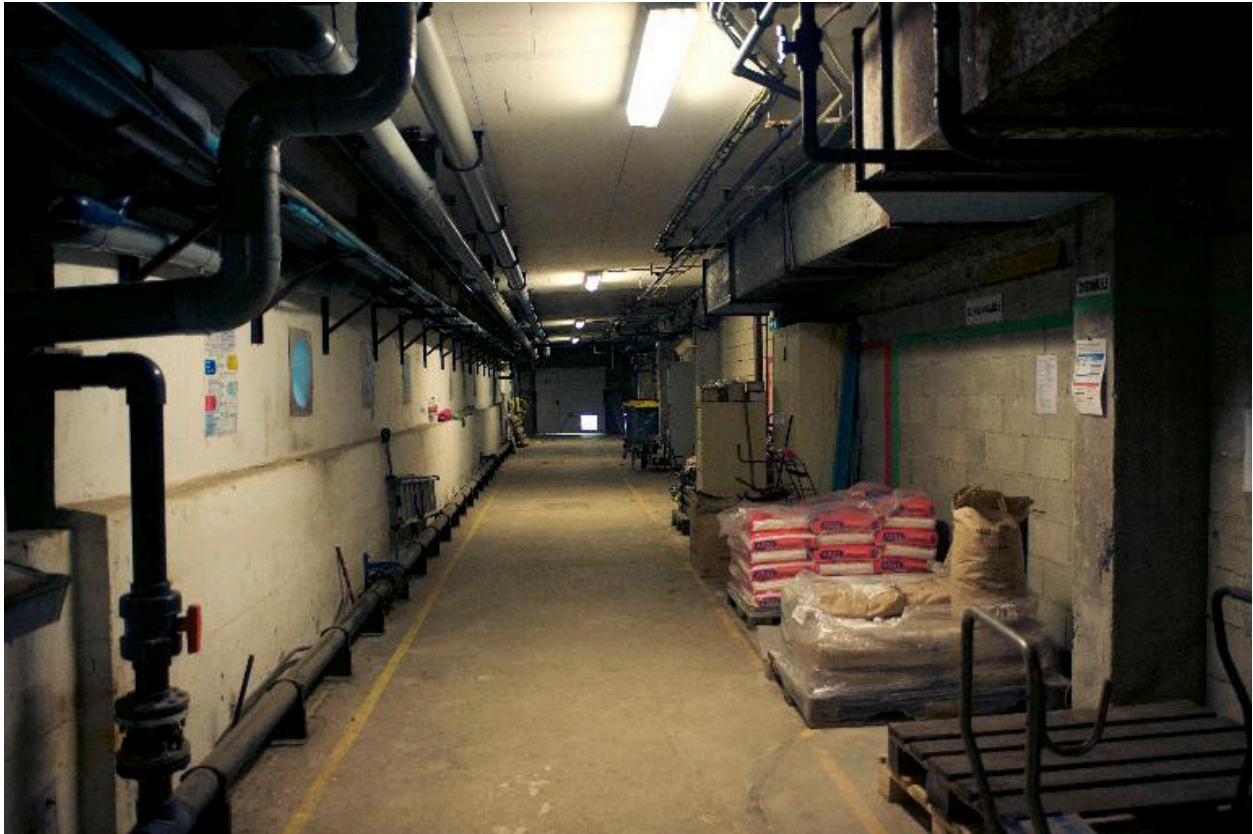
Entrée de la galerie technique; des hublots permettent de voir dans les bassins.
