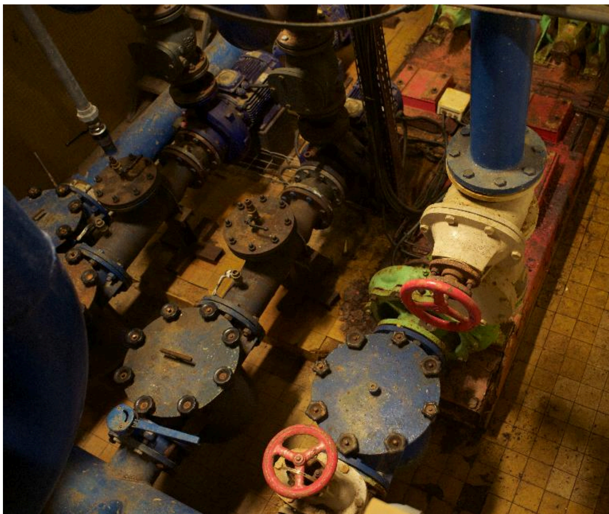
Vannes des bassins extérieurs.
