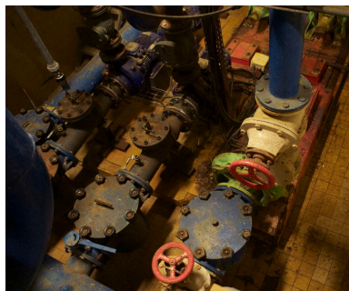
Vannes des bassins extérieurs. Phot. Marie-Laure Monnehay-Vulliet IVR32_20170200264NUC2A
