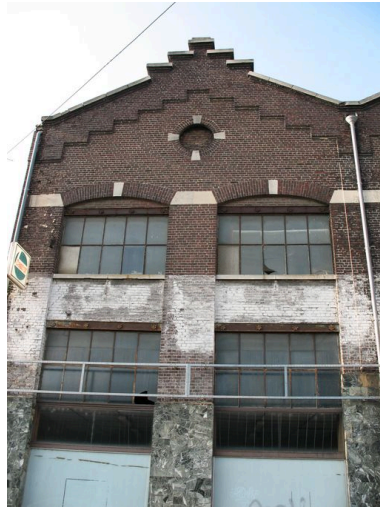
Détail de la façade sur la rue Jean-Jaurès. Phot. Clarisse Lorieux IVR22_20066005179NUCA
