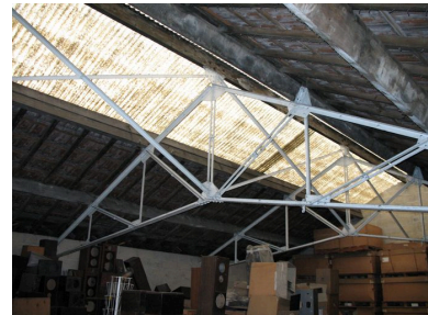
Détail de la charpente métallique apparente dans l'une des mezzanines. Phot. Clarisse Lorieux IVR22_20066005195NUCA
