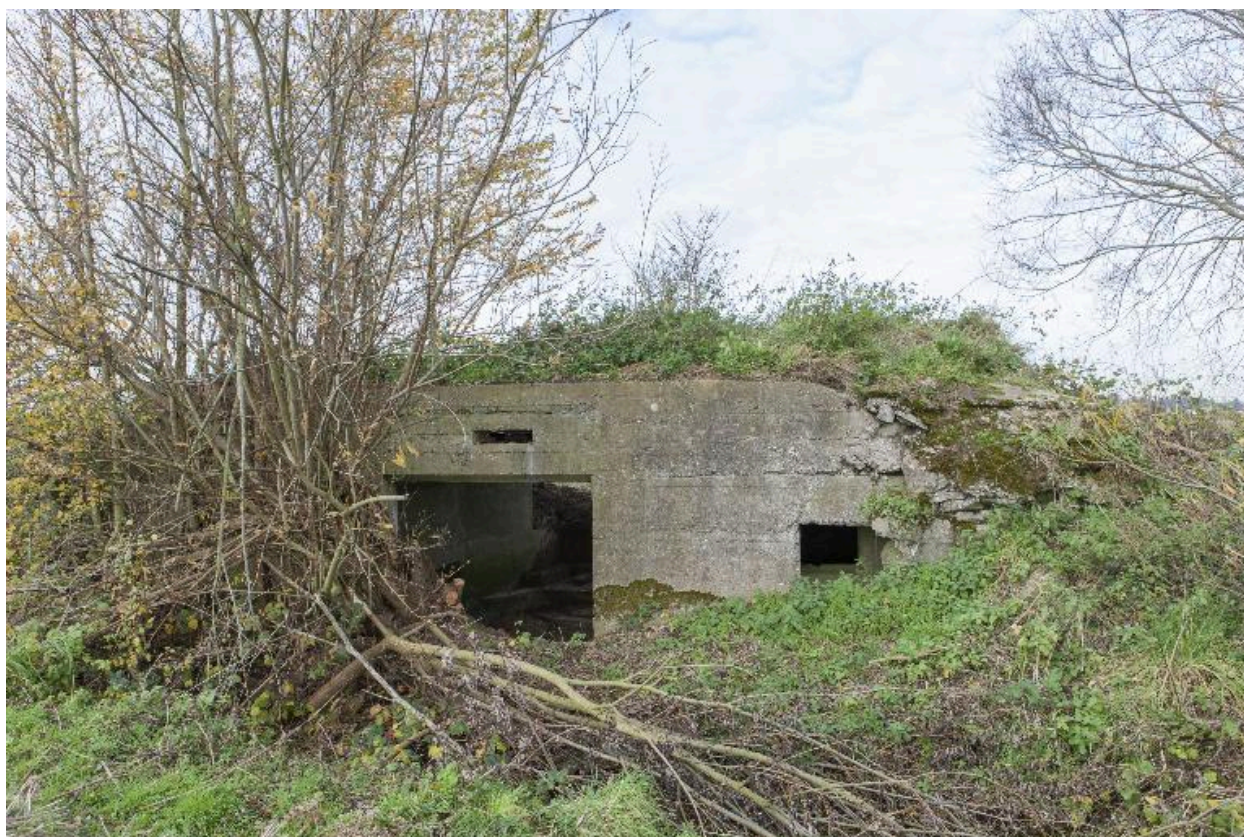
Elévation sud-est : entrée de la chambre de tir et abri à personnel, à droite
