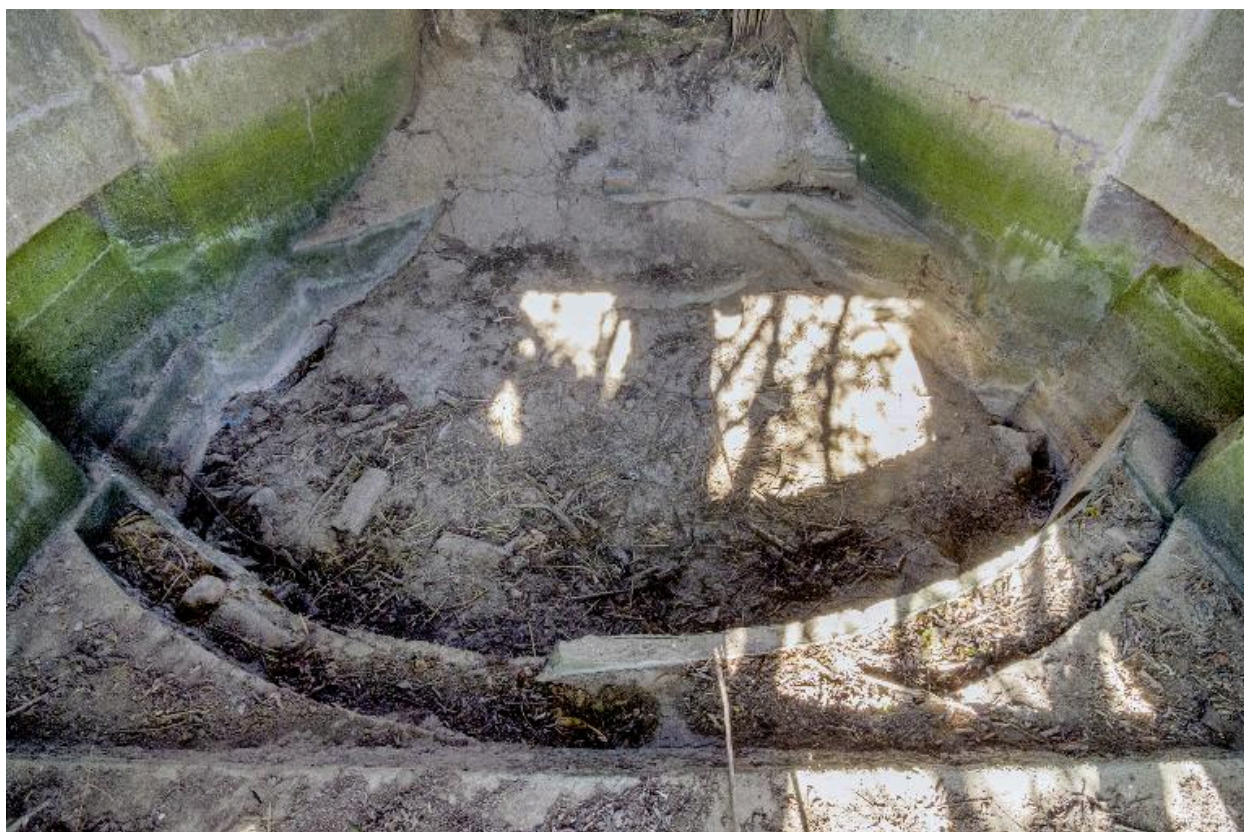
Vue intérieure vers le sortie de la chambre de tir avant déblaiement.
