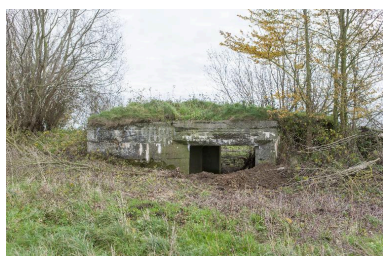
Élévation nord-ouest : sortie de la chambre de tir Phot. Pierre Thibaut IVR31_20155902018NUCA
