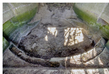
Vue intérieure vers le sortie de la chambre de tir avant déblaiement. Phot. Jean-Marc Ramette IVR32_20175901053NUCA
