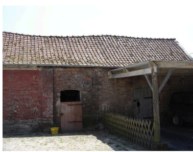
Vue de l'extrémité nord des étables à cochons. Phot. Inès Guérin IVR22_20058005835NUCA
