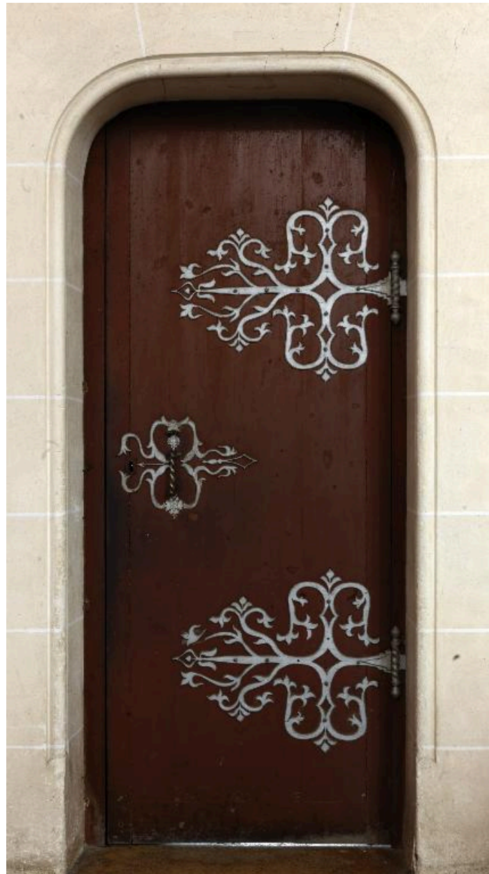
Porte de la sacristie dans une arcade du mur sud du chœur.
