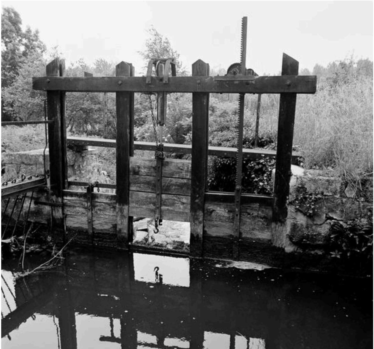
Vannes de décharge.
