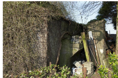
Elévation postérieure ou tournant le dos au front avec la banquette d'infanterie qui règne le long de la partie gauche de cette élévation, vue prise en enfilade depuis le flanc droit de la casemate. Phot. Pierre Thibaut IVR31_20145905285NUCA
