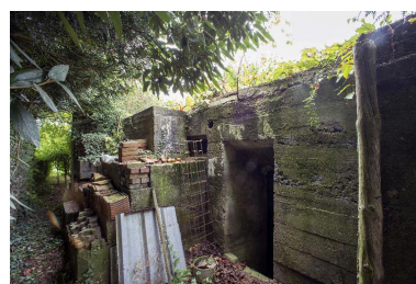
Elévation postérieure ou tournant le dos au front avec, en son centre, l'escalier permettant d'accéder à la plateforme, vue prise en enfilade depuis le flanc gauche de la casemate. Phot. Pierre Thibaut IVR32_20165901321NUCA
