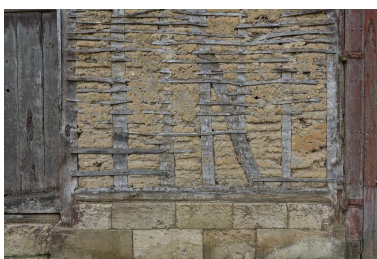
Détail de la mise en œuvre du solin et du torchis pan de bois, grange au n°41 Grande Rue. Phot. Lucile Chamignon IVR32_20226005006NUCA
