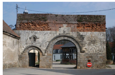
Le portail de l'ancien manoir, donnant accès à la ferme (date portée 1623). Phot. Thierry Lefébure IVR22_20038000258NUCA
