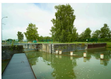
Tête amont. Estacades de guidage et portes battantes.
