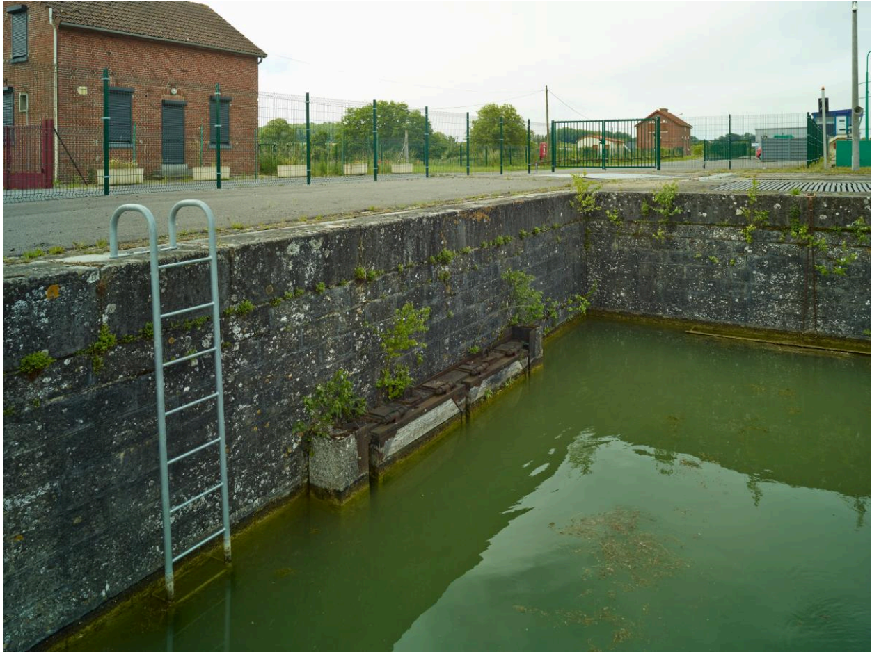
Le bassin de tranquillisation avec échelle de secours. Au second plan la maison de service (amont).
