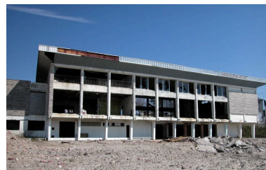
Le casino de 1966 en cours de démolition, mars 2005. Phot. Elisabeth Justome IVR22_20058003774NUCA
