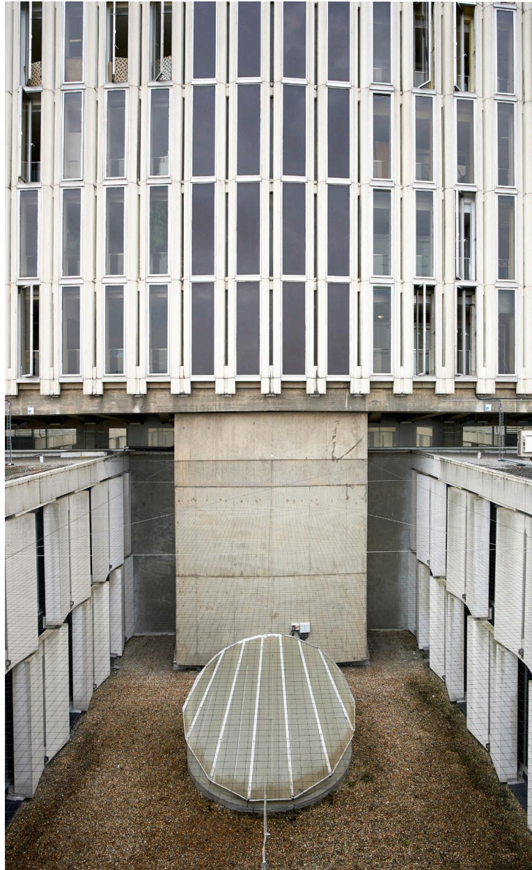
Courette au nord de la parcelle, correspondant à la couverture de l'ancienne petite salle d'audience.
