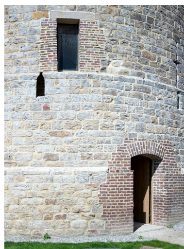
Vue de détail du sud-est de la tour, prise depuis le parking. Phot. Delphine Volto-Jourdan IVR32_20216200866NUCA4A
