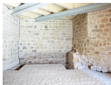
Vue de détail du rez-de-chaussée, vestiges des fondations médiévales des fortifications de Béthune. Phot. Delphine Volto-Jourdan IVR32_20216200869NUCA
