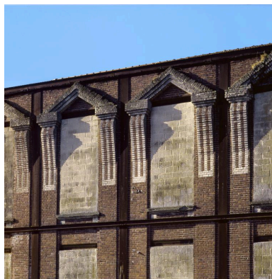
Détail du décor de brique en encadrement de baie. Phot. Thierry Lefébure IVR22_20058002434XA
