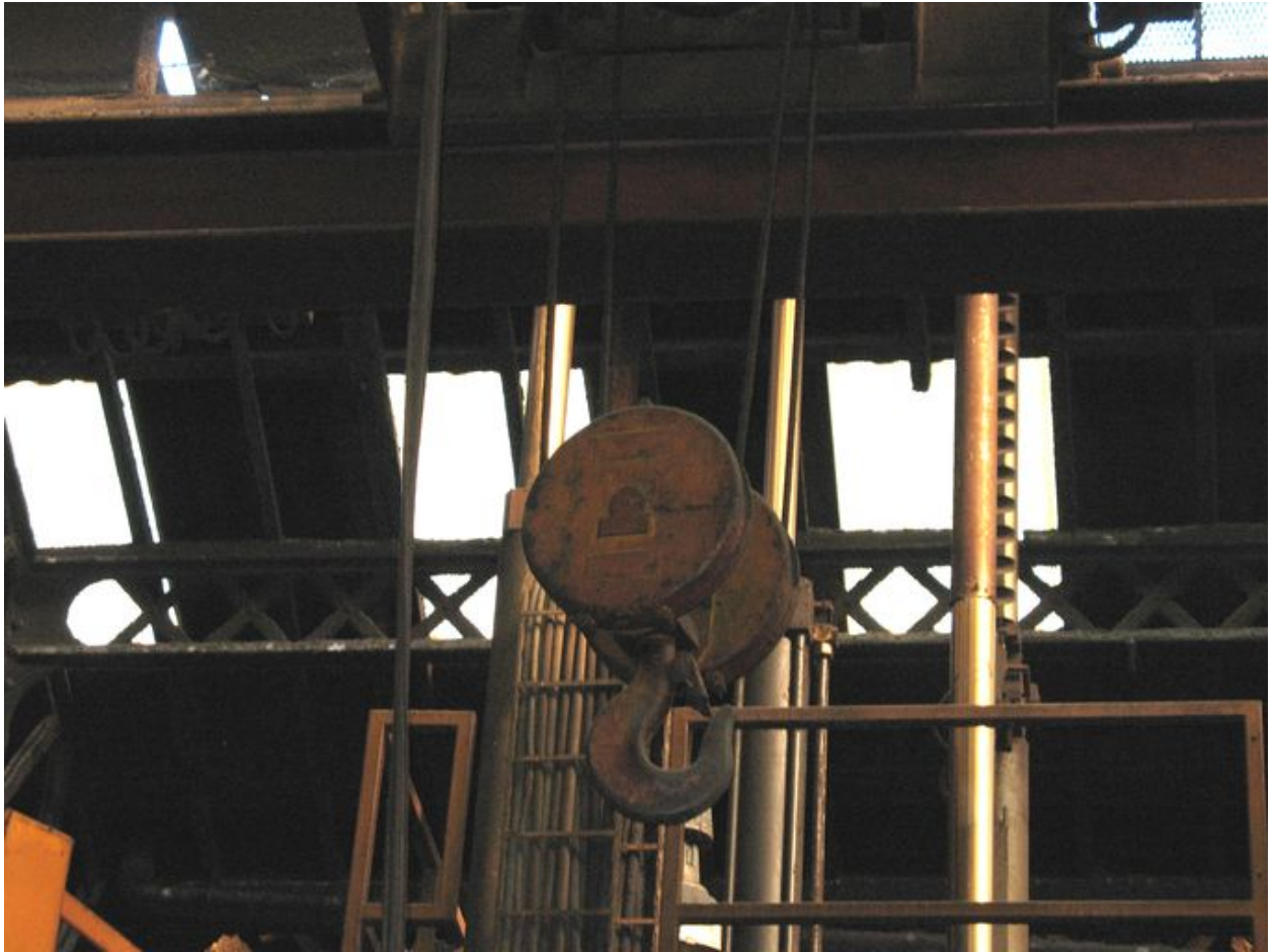
Treuil situé sous la halle.
