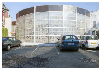
Vue du flanc droit de la chapelle depuis l'extérieur. Phot. Pierre Thibaut IVR31_20155900878NUCA
