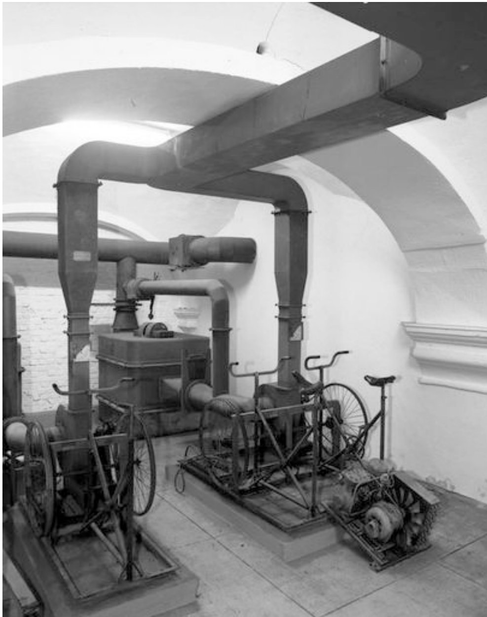
Corps de bâtiment fermant le flanc droit de la cour d'honneur, sous-sol, local où est installé un système de ventilation mécanique mû par plusieurs appareils à pédales, vue générale du système de ventilation.
