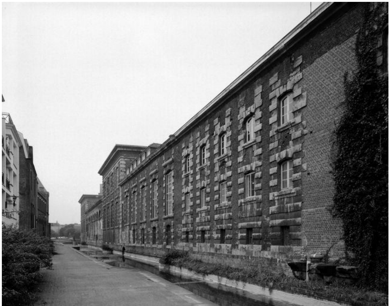
Elévation latérale droite donnant sur le canal de l'Escaut, vue générale prise de trois-quarts droit.
