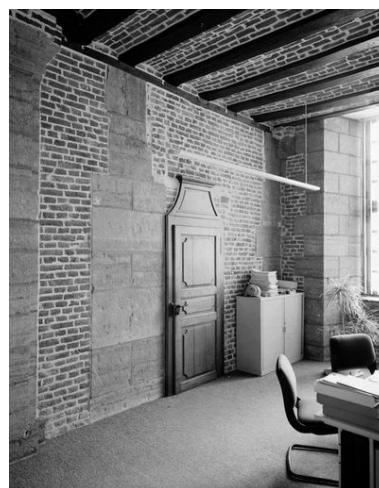
Corps de bâtiment fermant la cour d'honneur sur l'avant, rez-de-chaussée, pièce située à droite en entrant, couverte d'un plancher à entrevous en berceau segmentaire dit voûte picarde.
