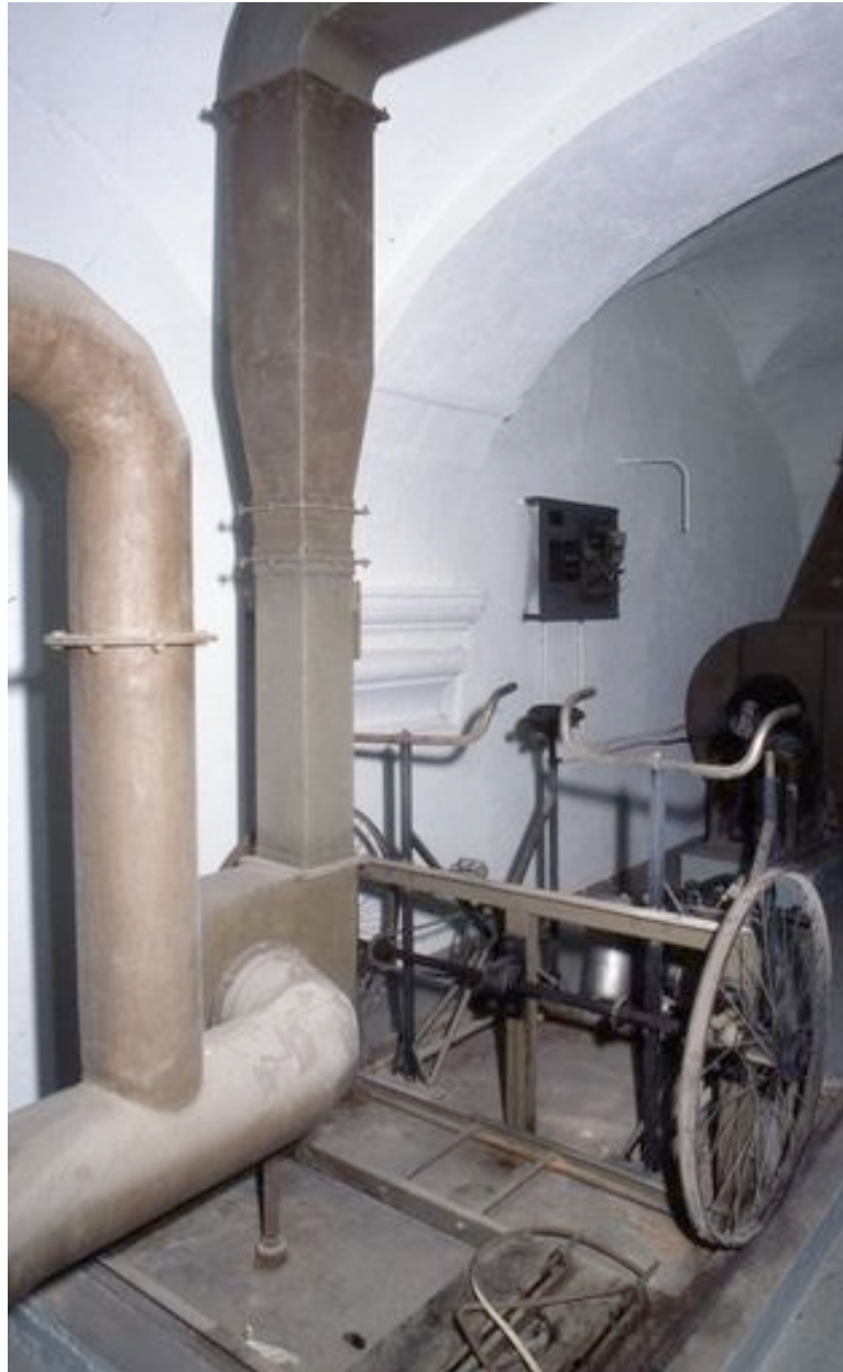
Corps de bâtiment fermant le flanc droit de la cour d'honneur, sous-sol, local où est installé un système de ventilation mécanique mû par plusieurs appareils à pédales, détail de deux appareils couplés.
