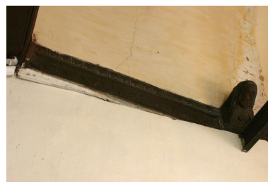
Vue détaillée de la sablière haute de la nef avec motifs géométriques et blochet bûché. Phot. Irwin Leullier IVR22_20078000127NUCA
