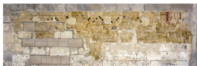
Décor de la travée gauche du mur de clôture nord. Phot. Thierry Lefébure IVR22_20010202832VA
