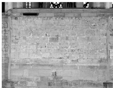
Décor de la travée gauche du mur de clôture sud. Phot. Thierry Lefébure IVR22_20010202814V
