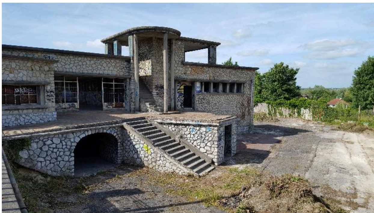
Vue du bâtiment des vestiaires de la piscine de la Cheminote à l'abandon, en juin 2017.
