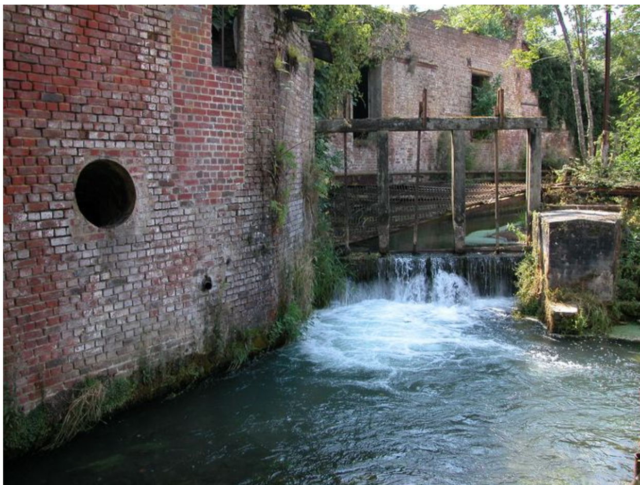
Détail du vannage de décharge.
