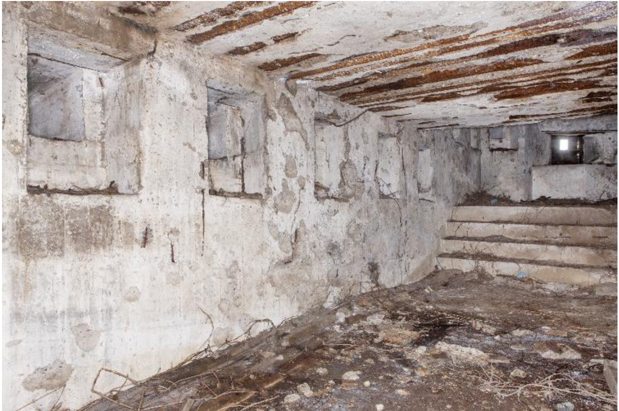
Créneaux de fusillade depuis le niveau intermédiaire vers le premier niveau intermédiaire
