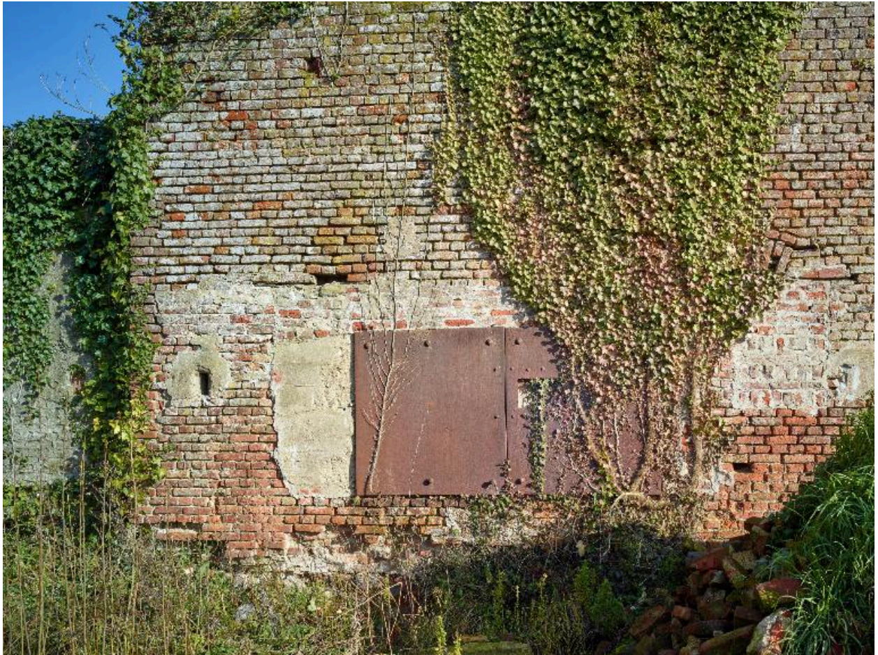
Plaque métallique masquant une ouverture de tir aménagée dans le mur ouest de la ferme, près de l'angle sud.
