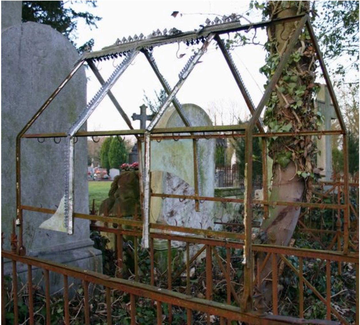
Auvent à usage de porte-couronne mortuaire, fixé sur la grille de clôture.
