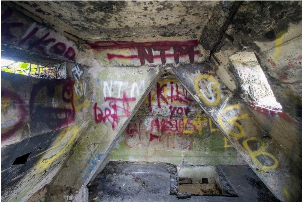
Charpente en béton armé. A gauche, un créneau de fusillade et, dessous, la niche à munitions
