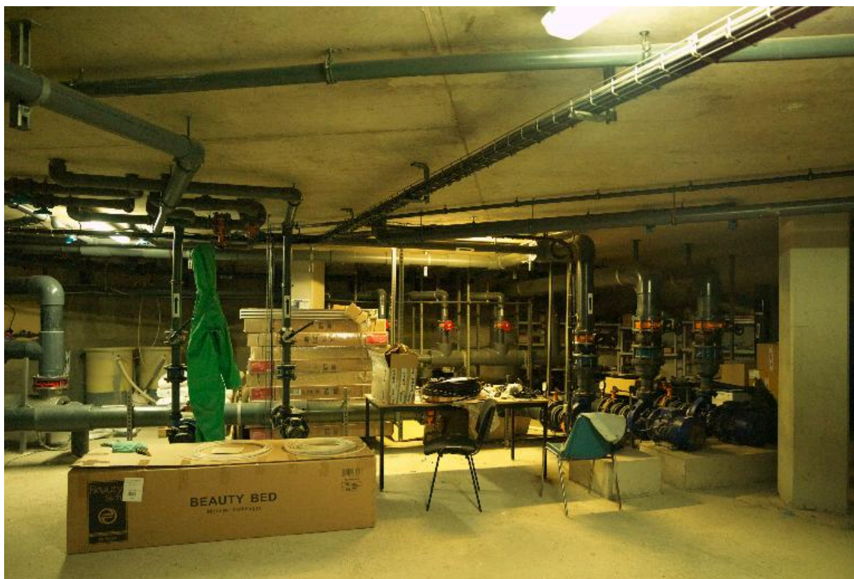
Vue générale du local technique.
