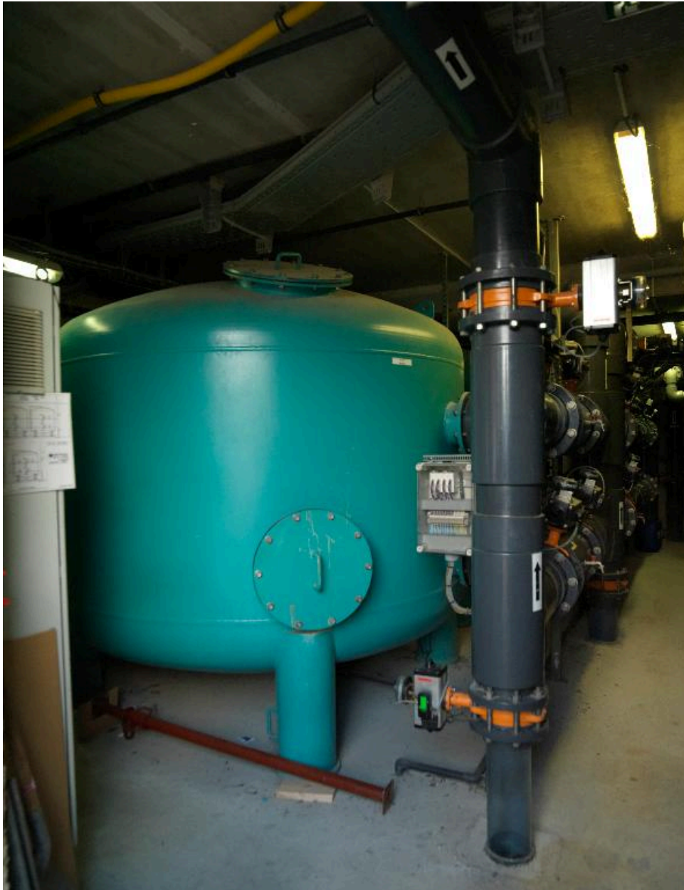
Local technique : cuve de filtration.
