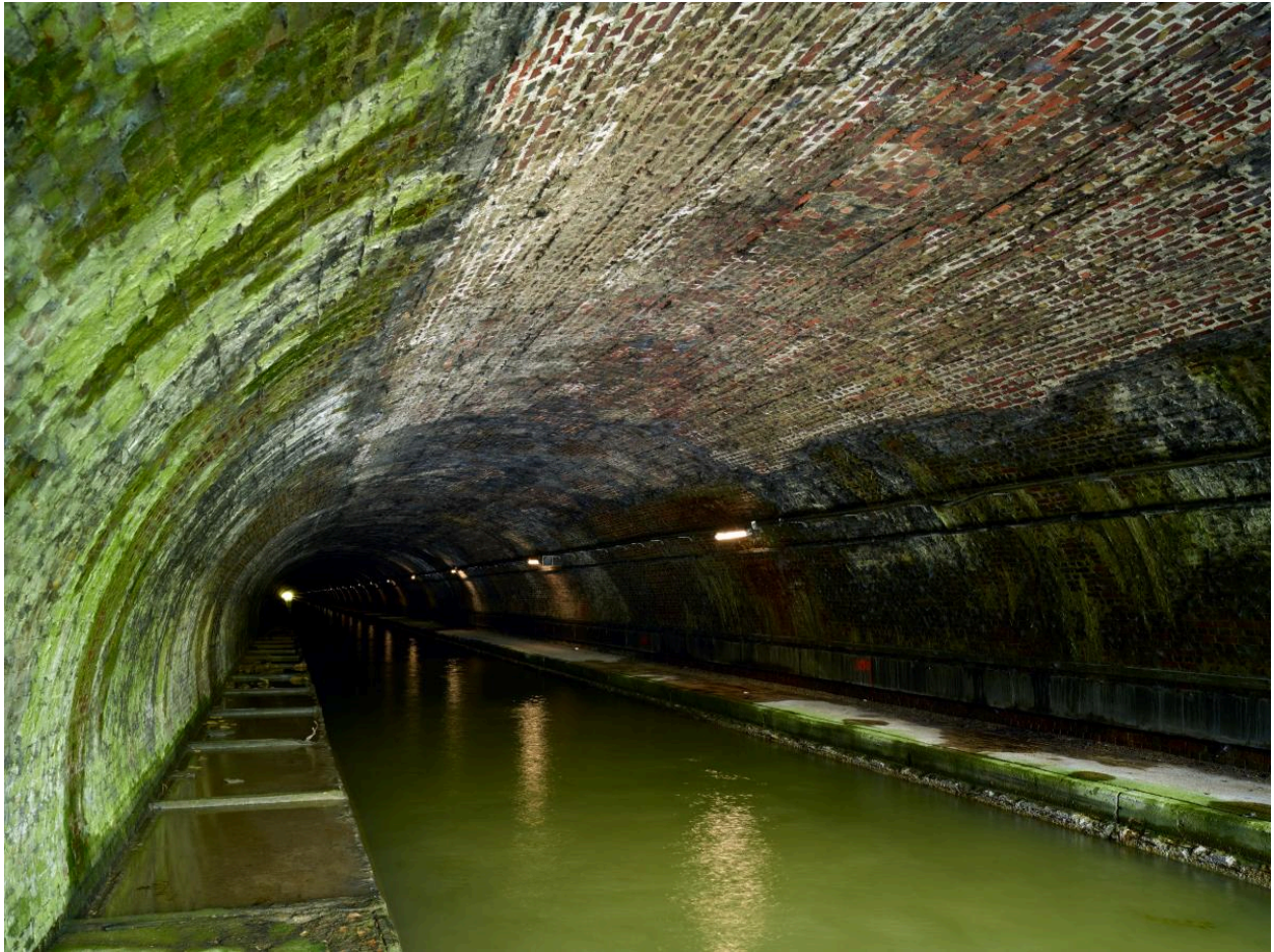
Intrados de la voûte en brique, cuvette de navigation et banquettes de circulation en béton.
