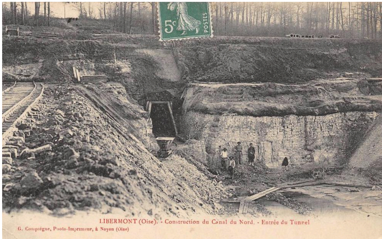
Entrée nord du souterrain de la Panneterie en cours de construction à Libermont (Oise). Carte postale, entre 1908 et 1914.
