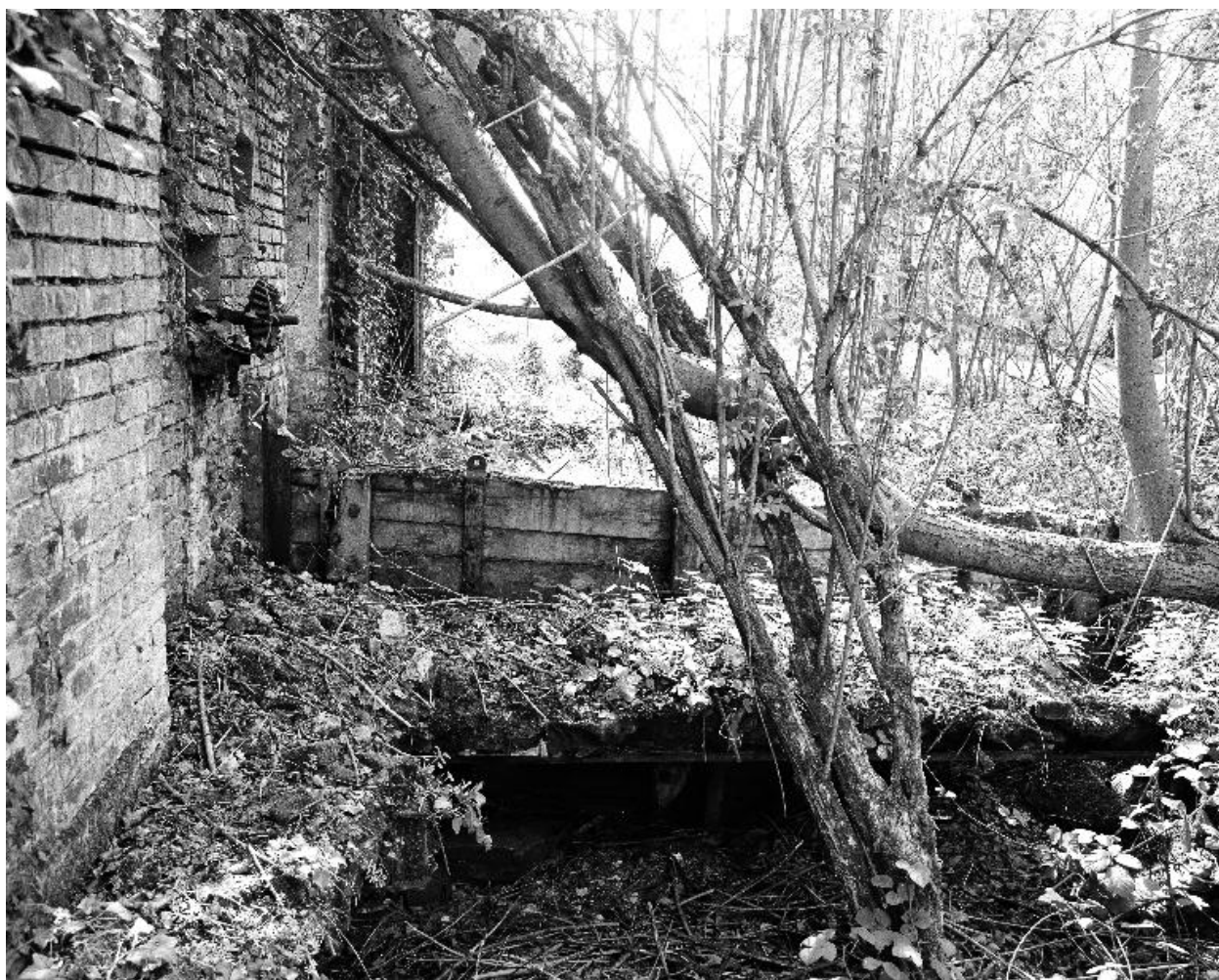
Vannes de décharge.
