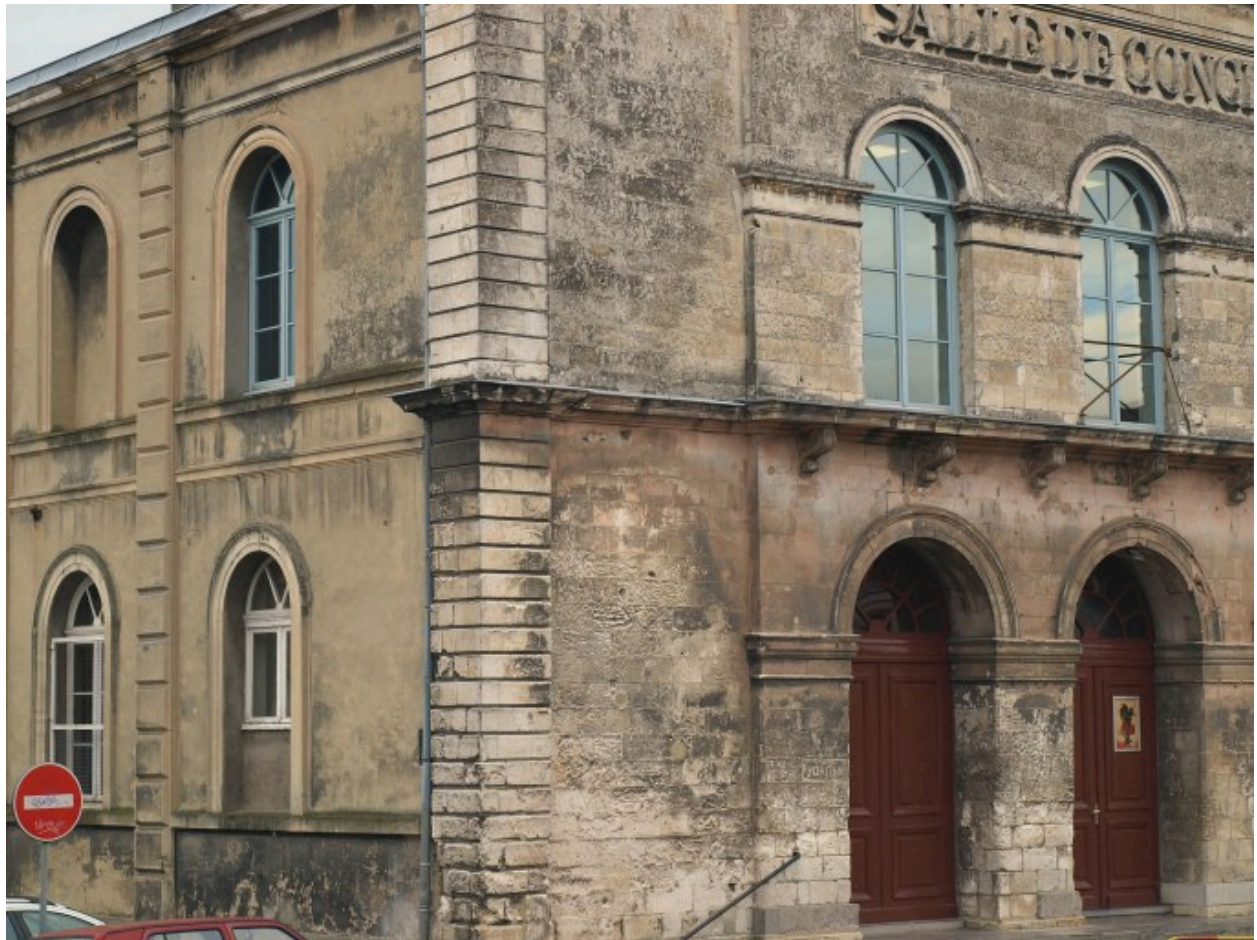
Détail : traitement de l'angle de jonction entre la façade principale et la façade latérale nord.
