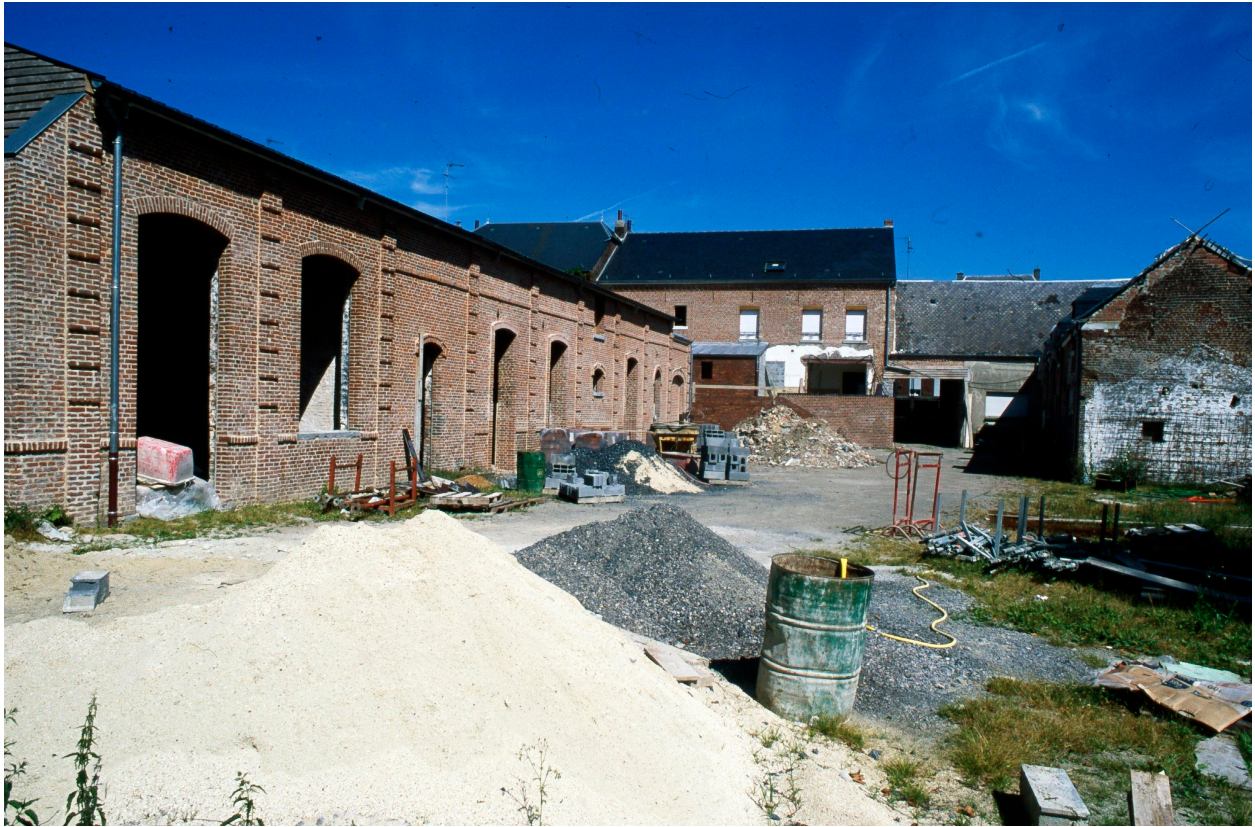
Vue générale de l'aile occidentale de l'ancienne brasserie-malterie, depuis la cour, en cours de restauration (août 2001).
