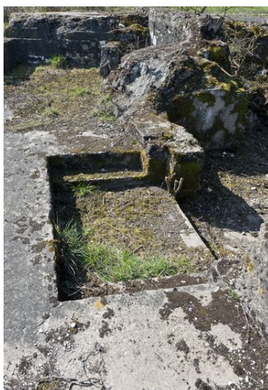
Casemate A. Depuis le couvrement, vers le sud-ouest : degré rectangulaire rentrant attestant un étage aujourd'hui disparu Phot. Jean-Marc Ramette IVR31_20145904222NUCA
