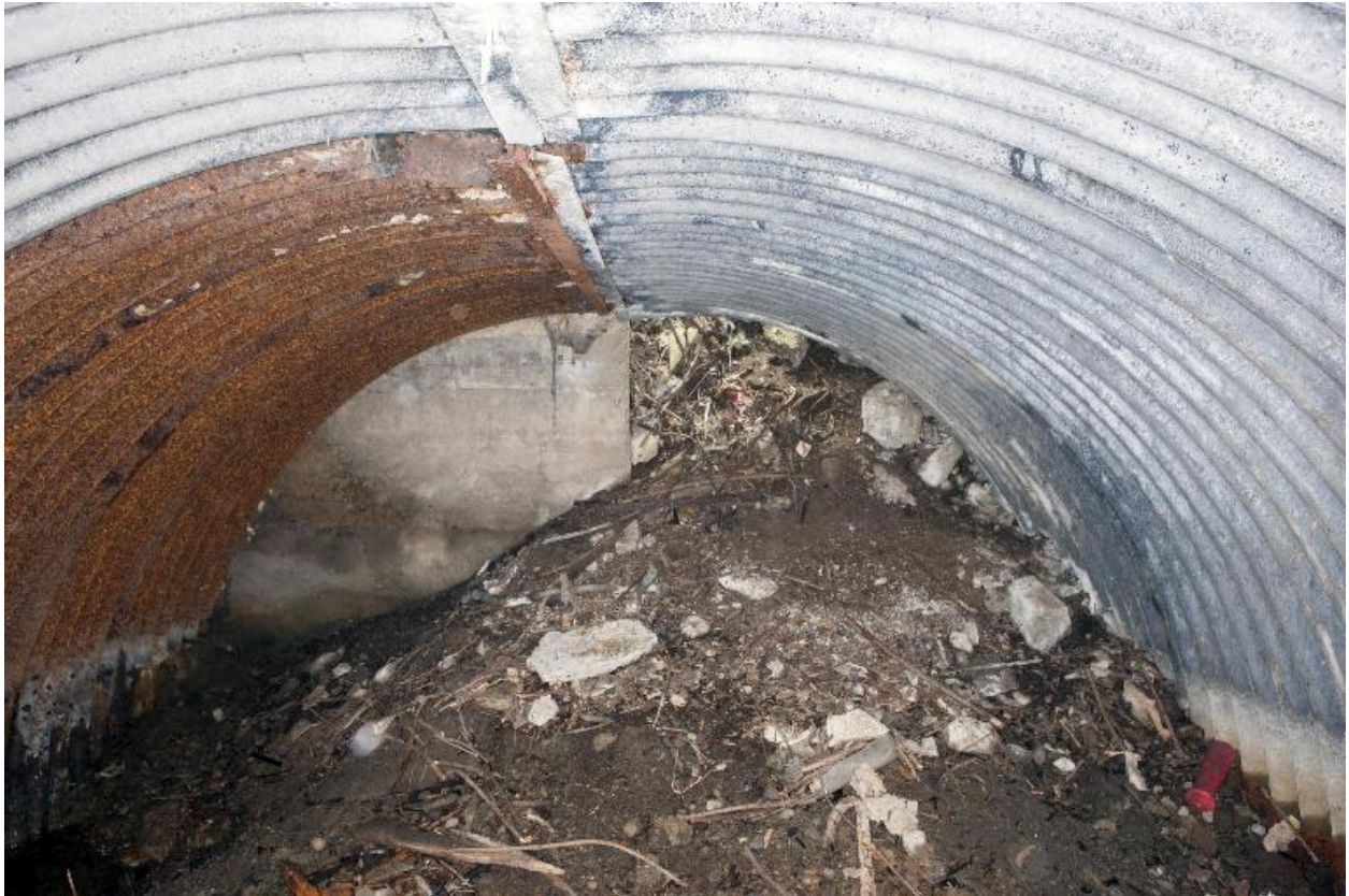
Casemate A. Salle perpendiculaire au couloir. Au fond : accès au poste de mitrailleuse (?)
