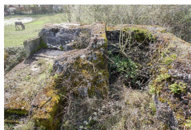
Bâtiment A : Partie explosée du toit, vers le sud-ouest Phot. Pierre Thibaut IVR32_20165900567NUCA
