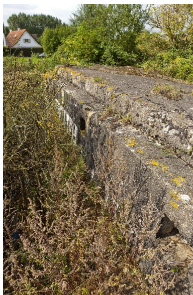
Casemate B: Elévation sud-est. Banquette d'Infanterie et niches à munitions, vers l'ouest Phot. Jean-Marc Ramette IVR31_20145904342NUCA
