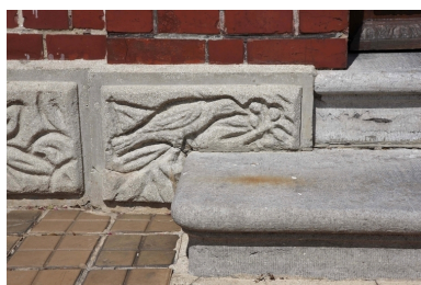
Détail du soubassement d'une maison située 1 rue du Quesnoy. Phot. Pierre Thibaut IVR31_20095902728NUCA
