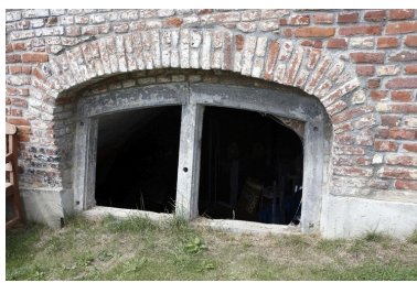
Détail d'une blocure ouverte située sur une maison (6 rue du Marais). Phot. Pierre Thibaut IVR31_20095902729NUCA
