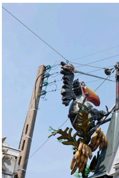
Détail de l'installation. Phot. Hubert Bouvet IVR31_20145902826NUC4A
