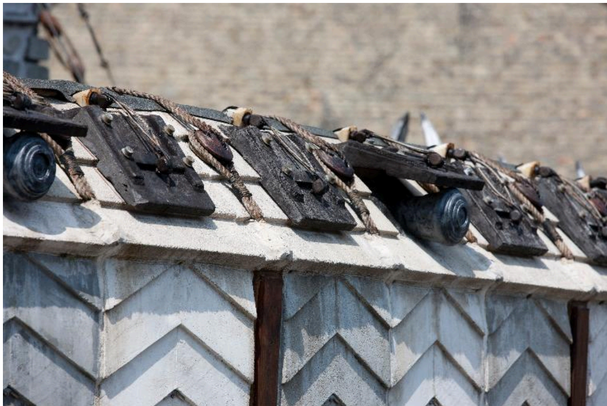
Vue partielle de l'installation.
