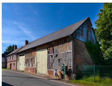
Ancienne grange sur rue, n°28 rue des Fresnes, vue depuis l'est. Phot. Marc Kérignard IVR32_20226000452NUCA
