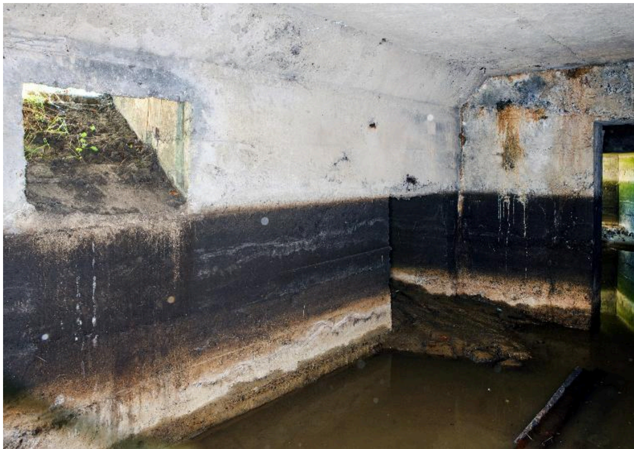
Salle est. De gauche à droite : aération, remise à mitrailleuse et passage vers la salle ouest
