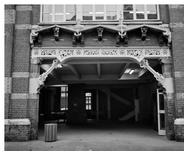
Deuxième travée (depuis la rue) du rez-de-chaussée de l'école primaire : poutrelles de fonte décorées d'oiseaux, de loutres (?) et de chenilles. Phot. Thierry Petitberghien IVR31_20025900364X
