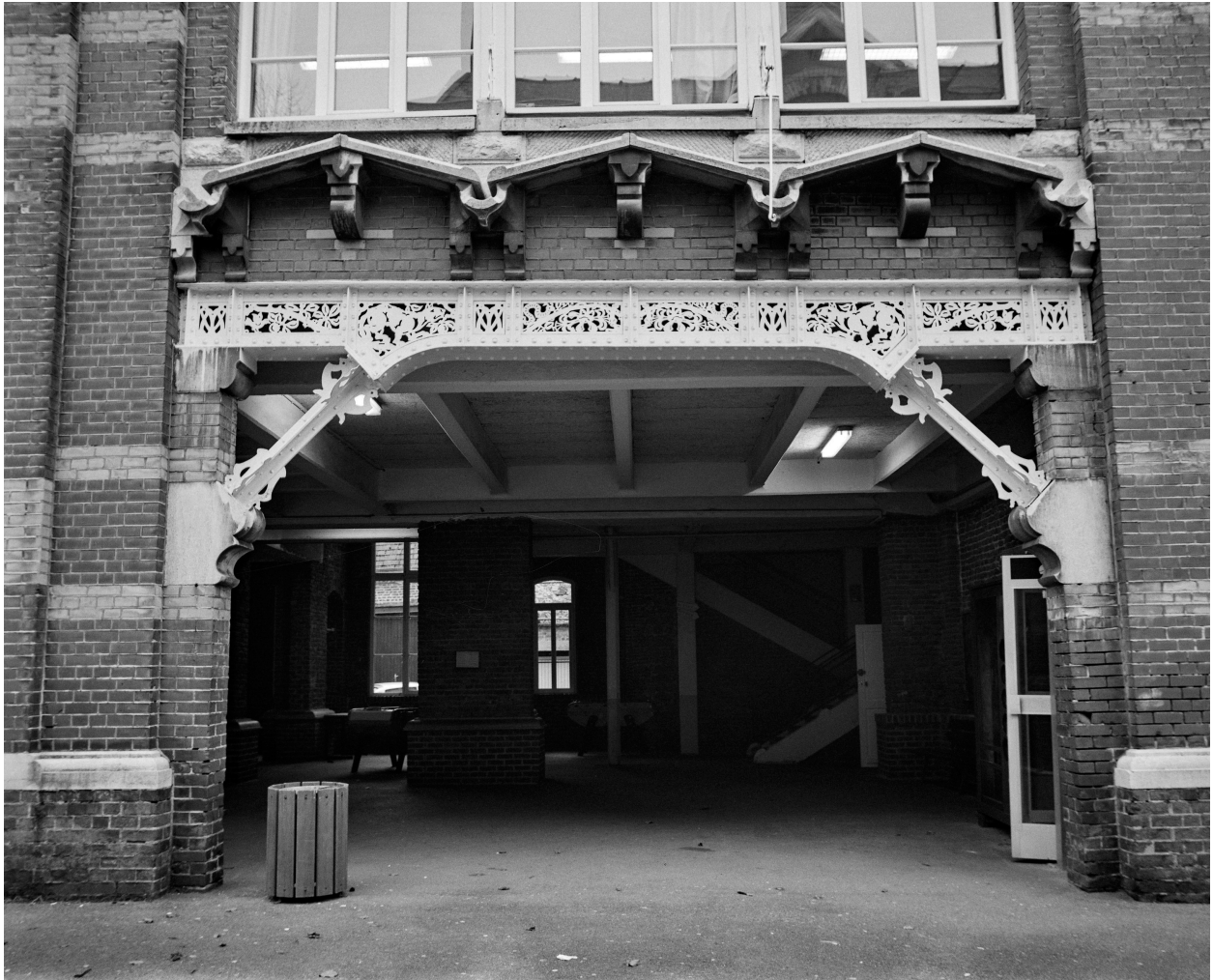
Deuxième travée (depuis la rue) du rez-de-chaussée de l'école primaire : poutrelles de fonte décorées d'oiseaux, de loutres (?) et de chenilles.
