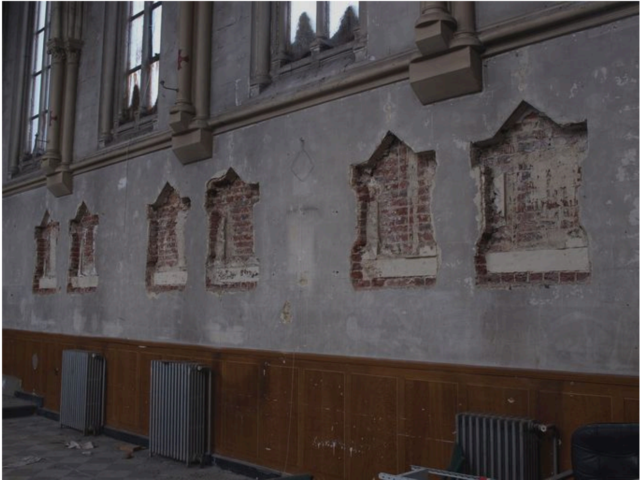
Chapelle, intérieur : traces d'arrachements du chemin de croix (nef).
