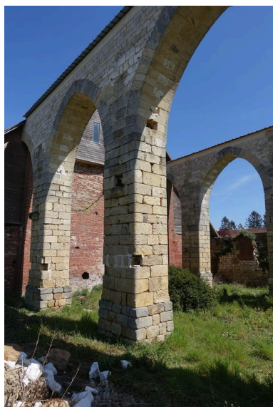
Vue rapprochée depuis le nord-ouest : piliers et arcades. Phot. Lucile Chamignon IVR32_20226005069NUCA
