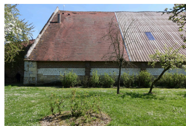
Vue générale de la partie nord-est de la grange. Phot. Lucile Chamignon IVR32_20226005072NUCA
