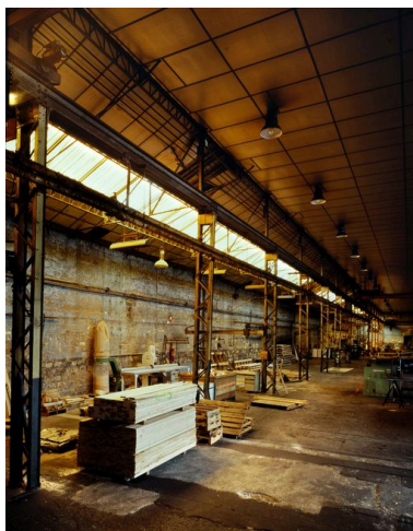
Structure métallique installée en remplacement des colonnes en fonte. Phot. Thierry Lefébure IVR22_20076000017VA
