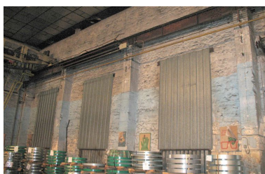
Fenêtres condamnées. Phot. Clarisse Lorieux IVR22_20066005135NUCA
