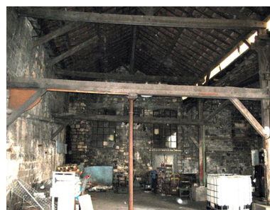
Intérieur des ateliers de fabrication construits le long de la rue des Usines. Phot. Clarisse Lorieux IVR22_20076005291NUCA
