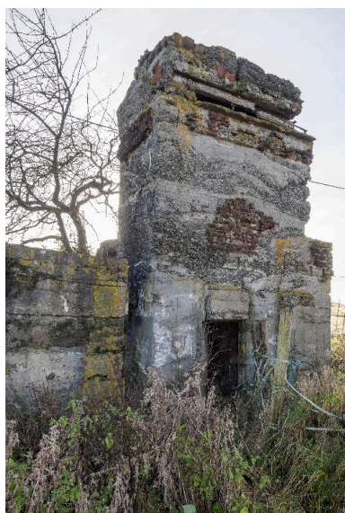
Tour d'observation casematée a, entrée sur l'élévation nord Phot. Jean-Marc Ramette IVR31_20145904987NUCA
