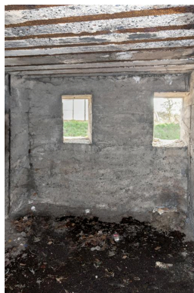
Casemate a. Vue intérieure de la salle ouest, vers la rue Phot. Jean-Marc Ramette IVR31_20145904989NUCA
