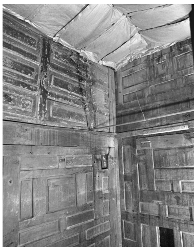
Vue d'ensemble des panneaux de lambris, provenant peut-être d'un meuble (chêne, 2e moitié 17e siècle). Phot. Franck Bürjes IVR22_19990204341X
