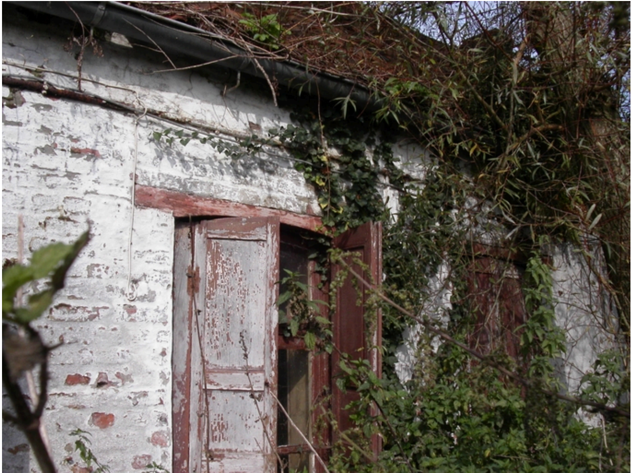
Logis situé 641, rue de la Pulmez, vue depuis la rue : linteau de fenêtre en bois (avec cintre), détail du logis (à l'abandon).
