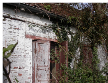
Logis situé 641, rue de la Pulmez, vue depuis la rue : linteau de fenêtre en bois (avec cintre), détail du logis (à l'abandon). Phot. Cyril Cailleau IVR31_20055907505NUCA
