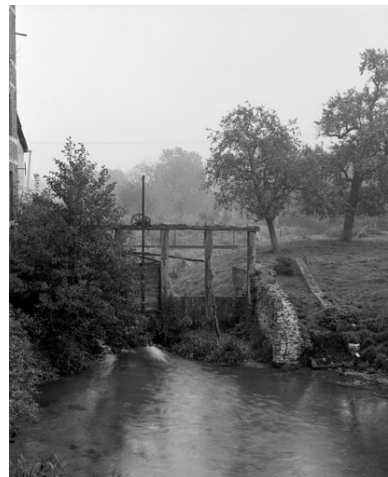
Vanne de décharge. Phot. Thierry Lefébure IVR22_19888001005X
