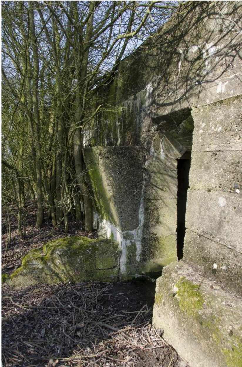
Profil taluté de l'élévation sud. A droite, l'entrée est, au centre, la banquette de tir
