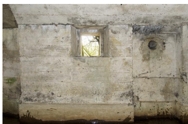
Baie dans l'élévation sud (pour escamoter la mitrailleuse ?) et conduit d'aération. Phot. Jean-Marc Ramette IVR32_20175901080NUCA
