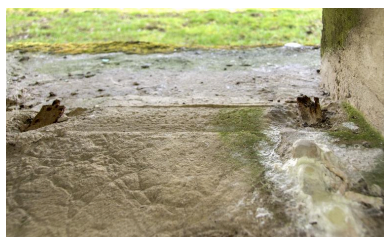
Vestiges du dispositif d'occultation de l'embrasure de tir et de surveillance Phot. Jean-Marc Ramette IVR32_20175901086NUCA
