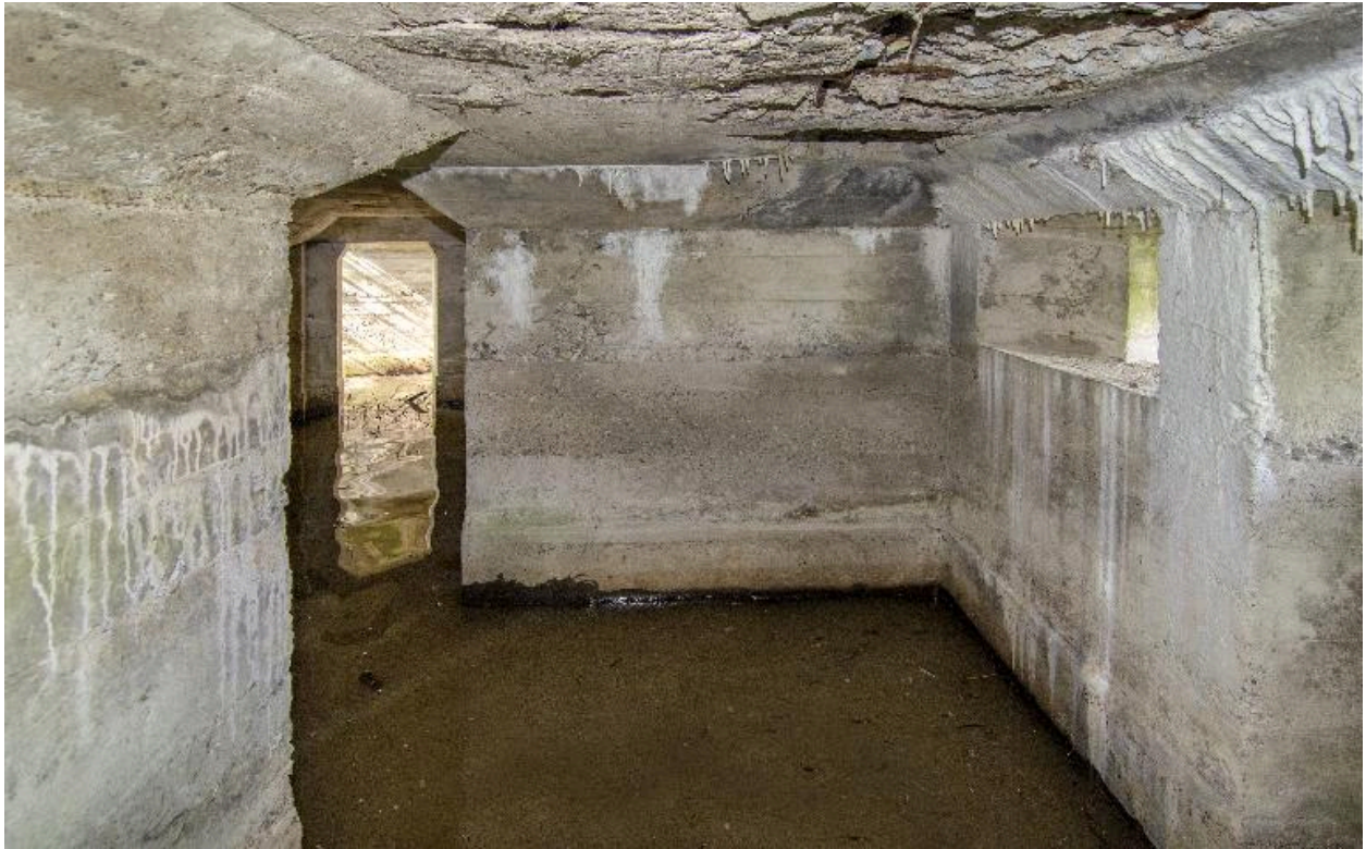
Vue générale, vers la sortie ouest. A droite le poste de tir et de surveillance
