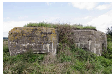
Vue latérale, vers le nord-ouest. A gauche, la tourelle sud. A droite l'entrée sud-est Phot. Jean-Marc Ramette IVR31_20145905081NUCA
