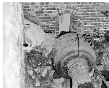
Turbine hydraulique (état de 1993). Phot. Olivier Marlard IVR31_19936200461X
