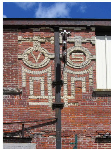
Détail du décor de brique et des initiales V et S, façade sud-ouest de l'atelier principal. Phot. Bertrand Fournier IVR22_20158005974NUCA
