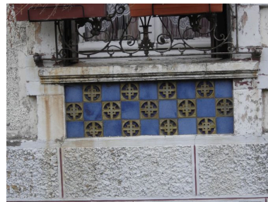
Vue détaillée des carreaux de céramique sous les baies. Phot. Inès Guérin IVR22_20068005163NUCA
