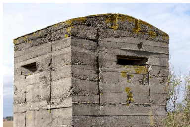
Ebrasures sud-est (vers Aubers) et sud-ouest (vers le front) Phot. Jean-Marc Ramette IVR31_20145904241NUCA
