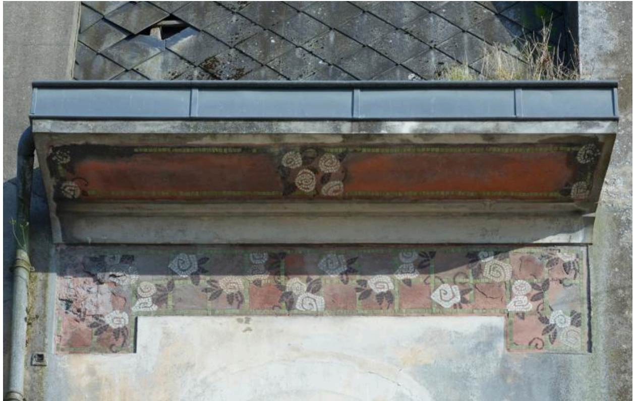
Vue de détail du décor de sgraffito qui soulignait les baies du premier étage de l'ancien hôtel aujourd'hui murées.
