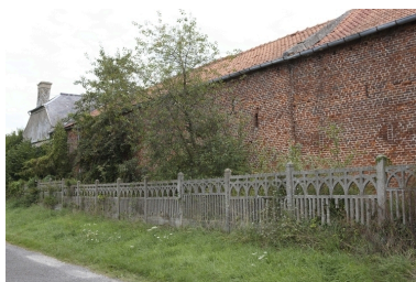
Vue du revers des écuries (sur la Grand'Rue) et du pignon du logis. Phot. Pierre Thibaut IVR31_20095902704NUCA
